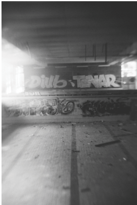
Grffiti and vandalism. Pankow Schwimmhalle
